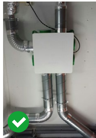
Een strak gemonteerde ventilatie-unit. Verbeterpunt: de bochten zijn niet glad vanbinnen waardoor extra luchtweerstand ontstaat.
